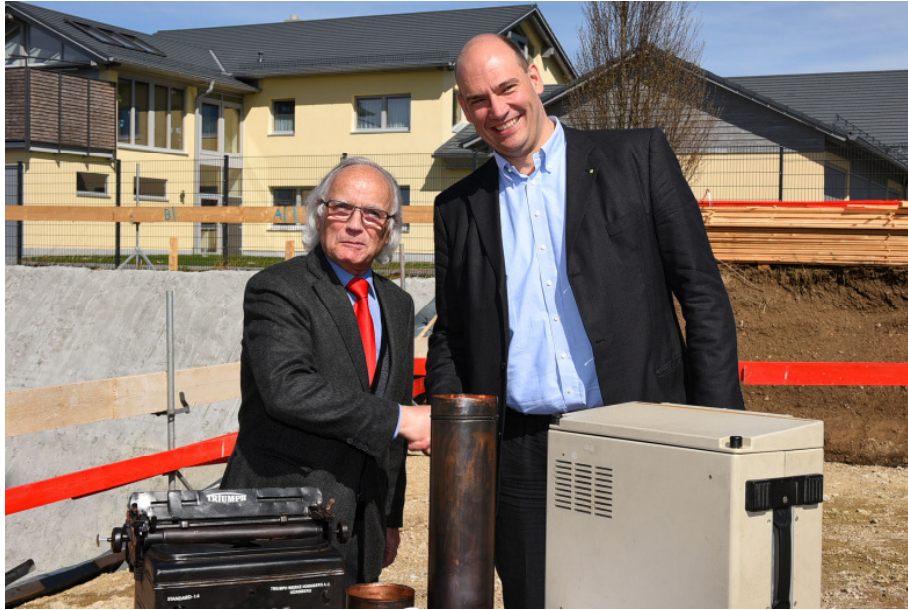
Bauherr und Firmengründer Peter Eichler (links) mit Michael C. Wisser (rechts), Vorsitzender der Geschäftsführung der WISAG Industrie Service Holding GmbH, bei der Grundsteinlegung für den Erweiterungsbau der EICHLER GmbH.
