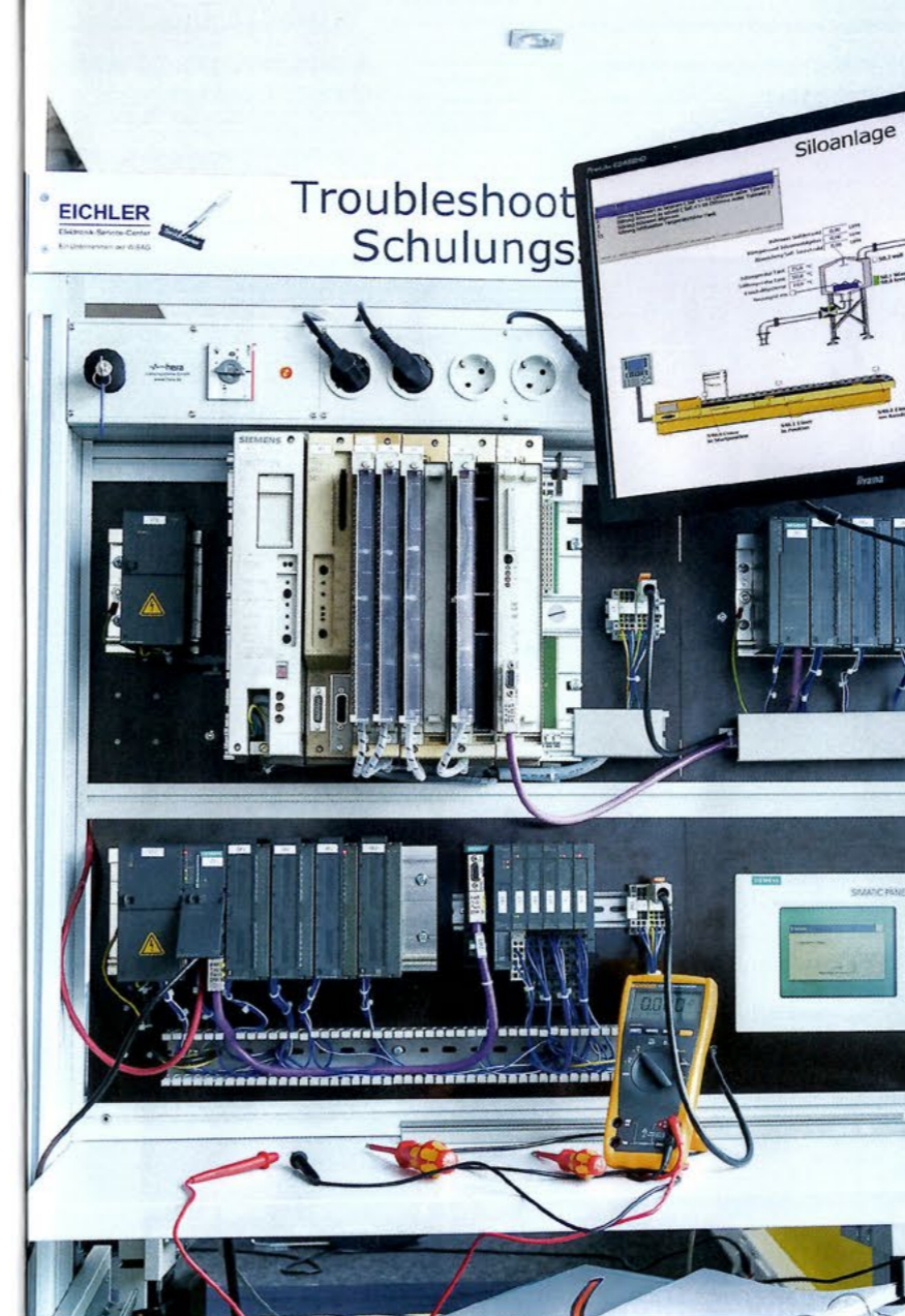
Die Fehlersimulationsracks bilden wie ein Flugsimulator für Instandhalter verschiedenste Störfälle innerhalb einer virtuellen Abfüllanlage auf Simatic S5 Basis ab.
